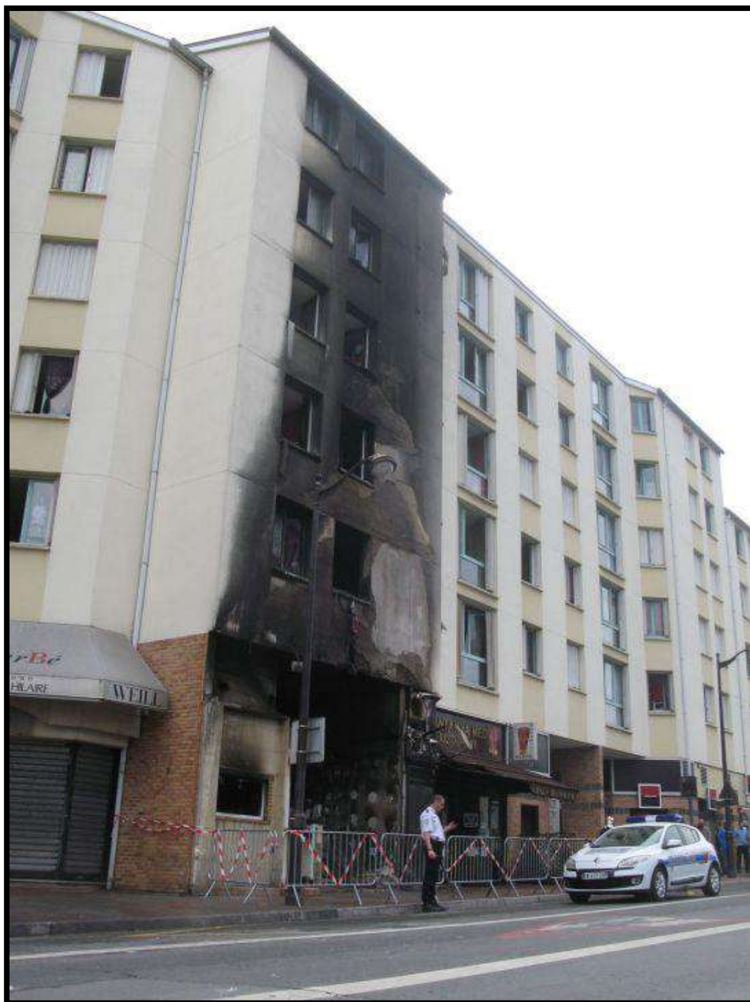
Incendie de Restaurant avec propagation à 1 Appartement secteur Creil
