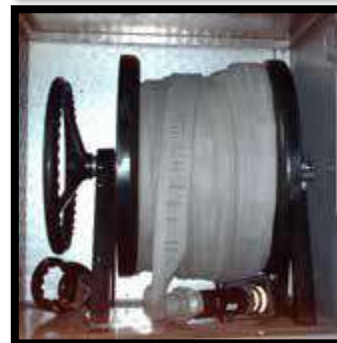
Tuyaux de 45 en dévidoir
