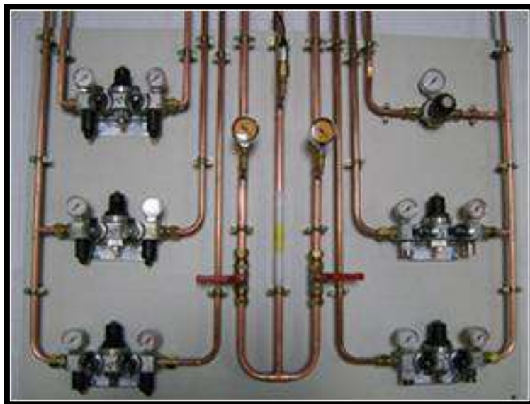
Exemple de vannes de sectionnement fluides médicaux (action réfléchie en concertation avec personnel présent)
