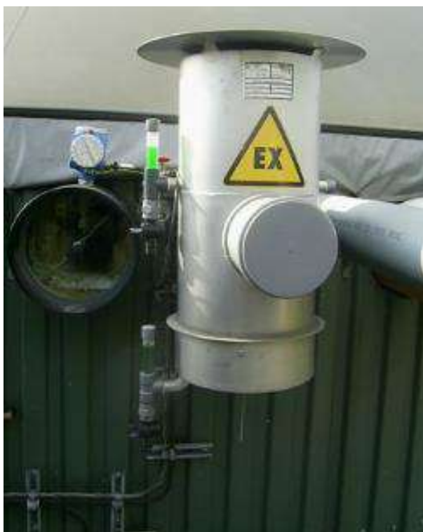
Soupape de sécurité © Bio-nrj
