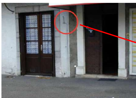
Robinet situé en façade © GRDF
