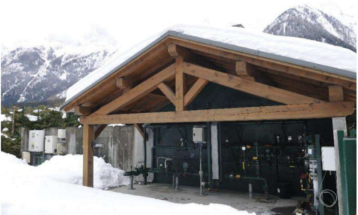
Poste de livraison à Chamonix © GRTgaz
