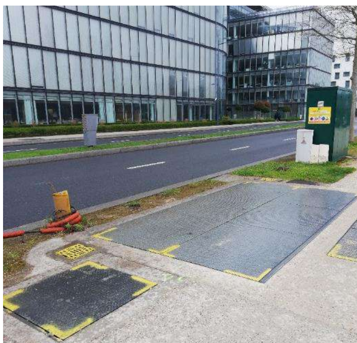
Poste enterré à Issy-les-Moulineaux © Christophe Perdrisot – DGSCGC
