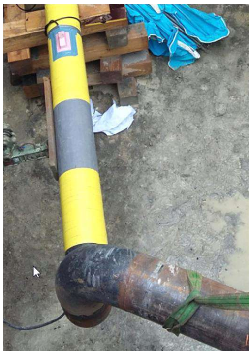
Canalisation en acier © GRDF
