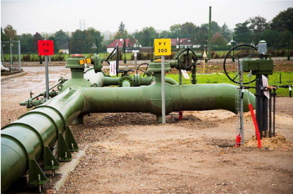
Station d'interconnexion de Férolles-Atilly (77) © GRTgaz
