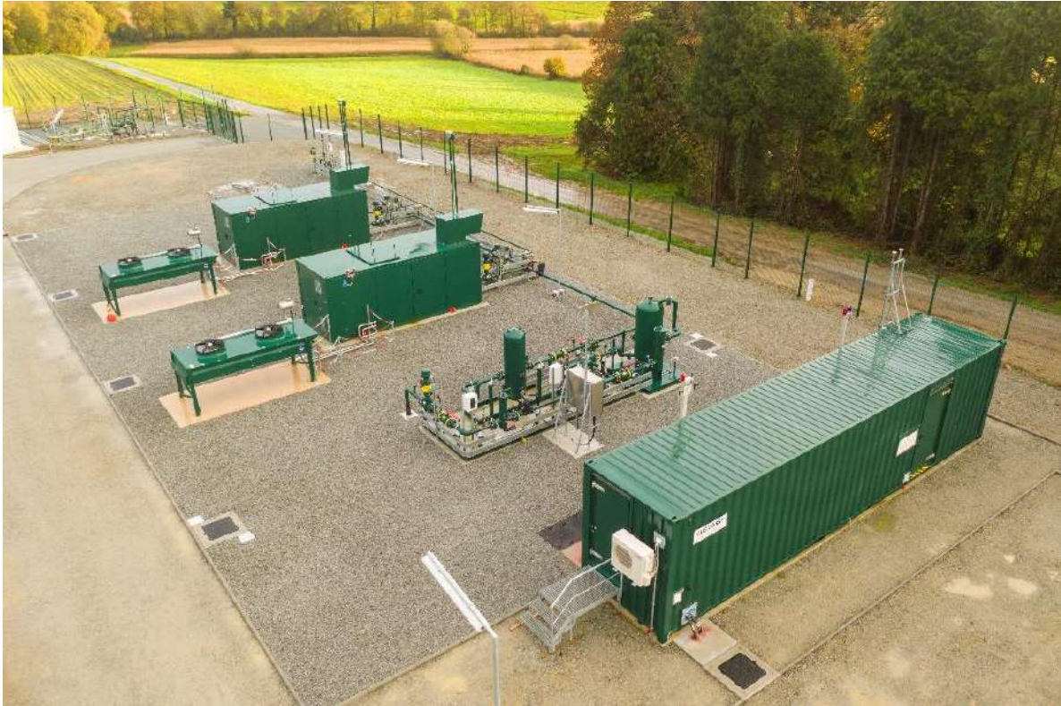
Poste de rebours de Noyal (35) © GRTgaz
