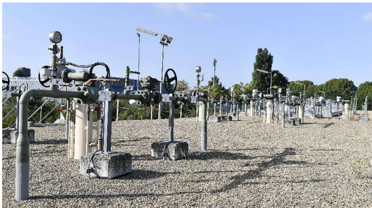
Poste de détente © GRTgaz
