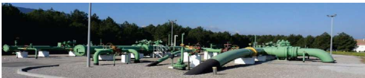
Poste de sectionnement © Teréga
