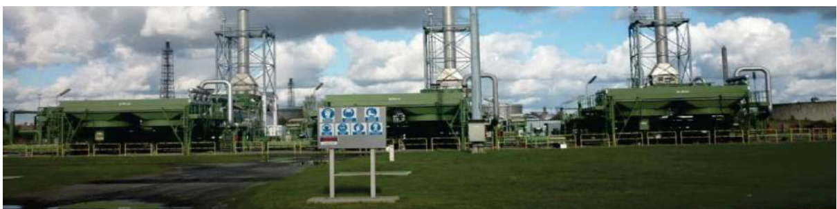
Station de compression © Teréga
